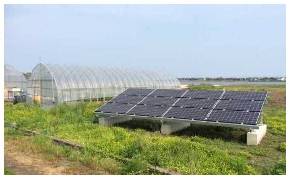
図 2 鳥取大学モデルシステムに導入した 3kW 太陽光発電システムの外観
